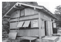
壁面の劣化やカビ
